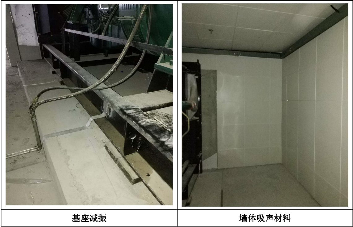
图 4.2-1 发电机噪声治理措施现场图
